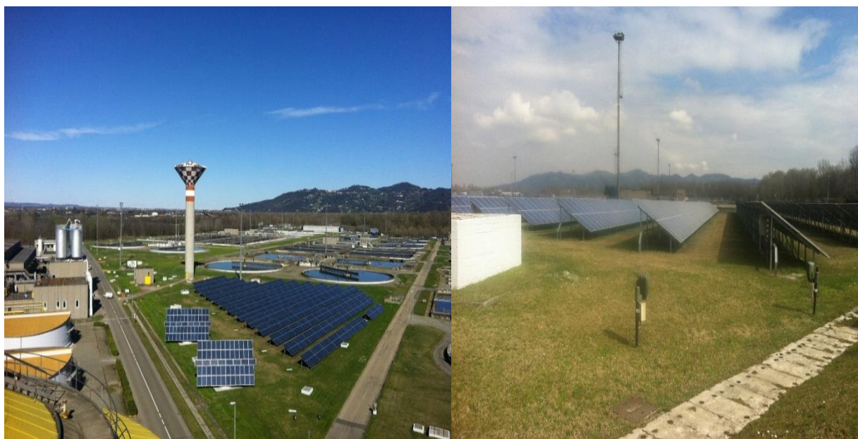
Fig. 61. Panouri fotovoltaice în interiorul amplasamentului STA SMAT, anul 2015.
