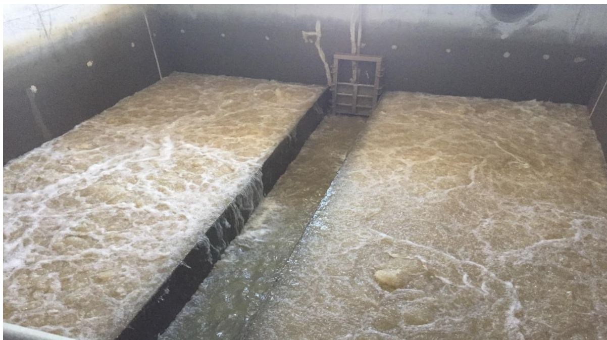
Fig. 14. Filtre din cadrul stației de tratare a apei Barați, Bacău.
